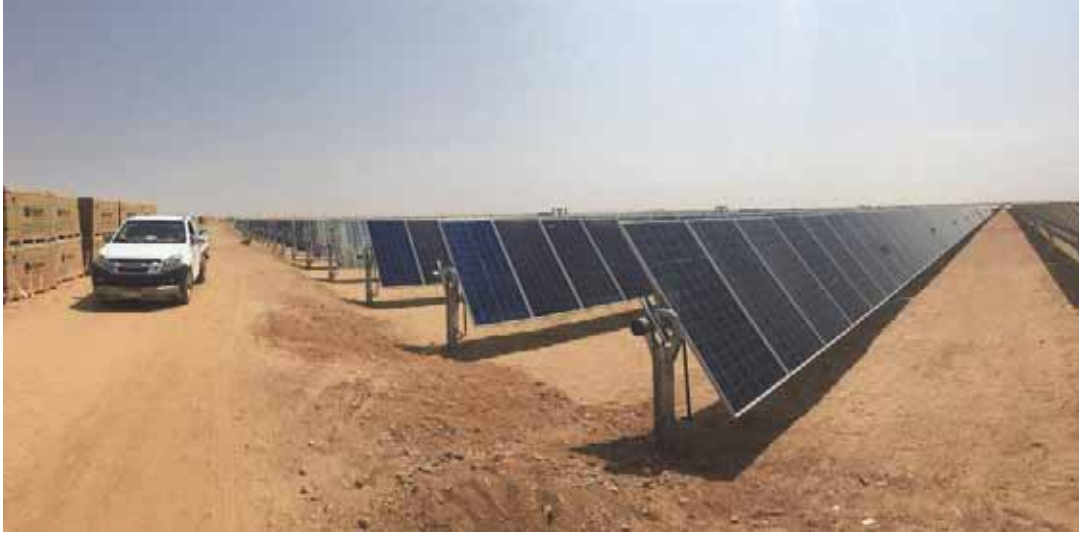
Şəkil 3.10: Tək oxlu izləmə sistemində quraşdırılmış PV modulları
